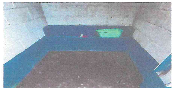
Foto 4: Mingitorios en mal estado
