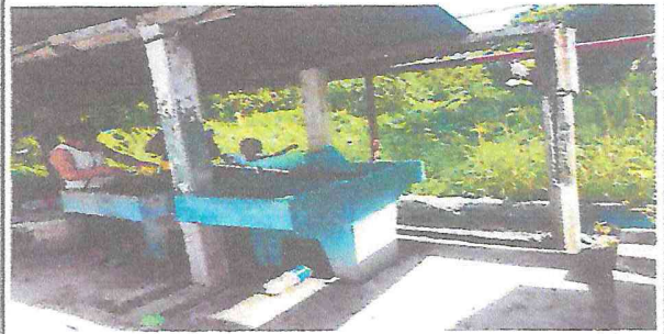
Foto 2: Pila en mal estado
