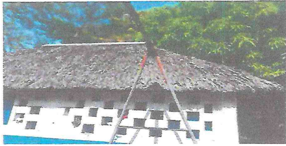
Foto 1: Pintura en mal estado
