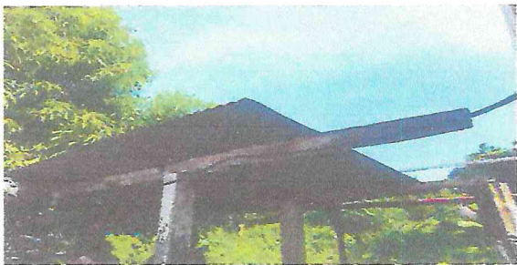
Foto 3: Lamina en mal estado
